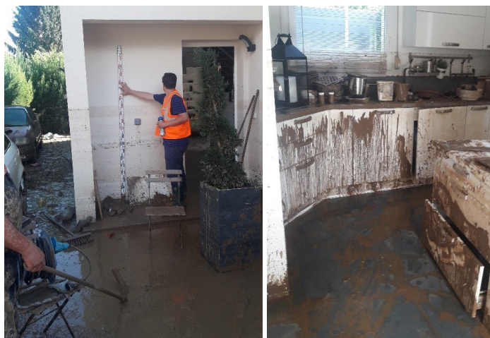
Photographies post événement du 1 er juin 2018. 1,3m d'eau boueuse à gauche et une cuisine dévastée à droite.
